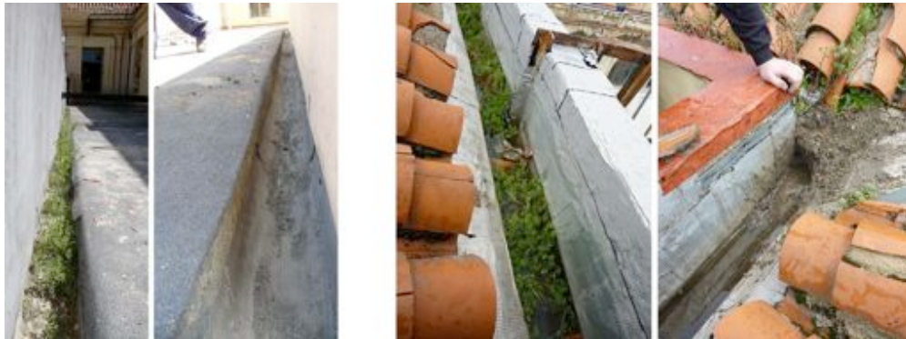
Fotografías del estado de los canalones de las terrazas, antes y después de la intervención
