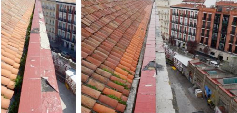
Fotografías del estado de los canalones de la fachada Sur, antes y después de la intervención (realizada por empresa especializada en trabajos verticales)
